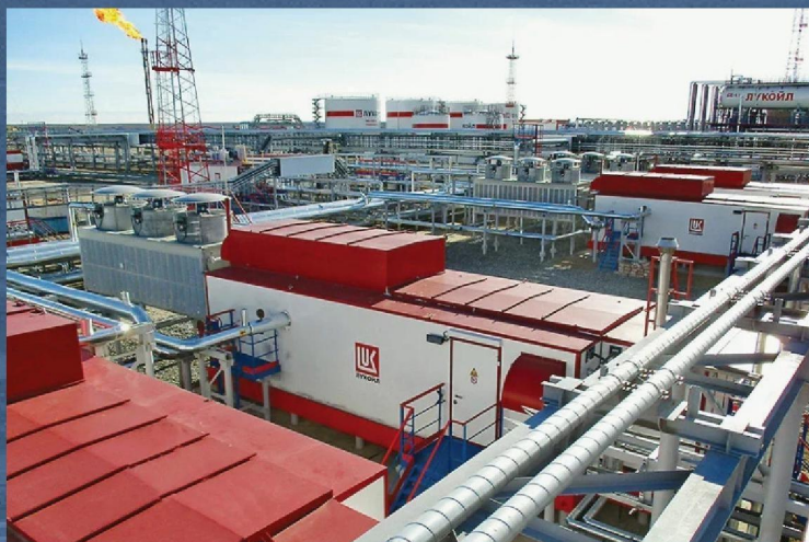
КОМПРЕССОРНАЯ СТАНЦИЯ НЕФТЯНОГО ГАЗА (КСНГ)
