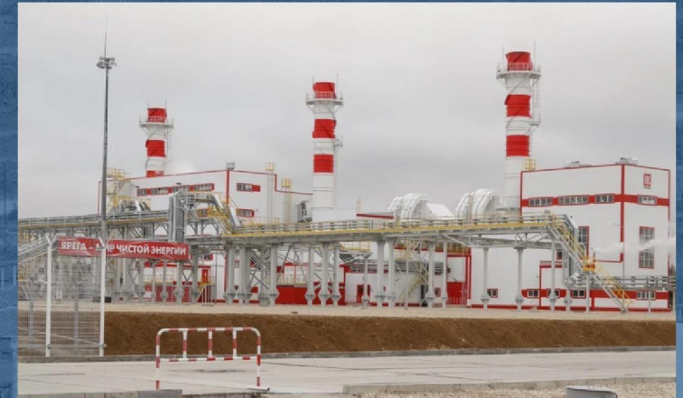
УСТАНОВКА ПОДГОТОВКИ ТОВАРНОГО ГАЗА
