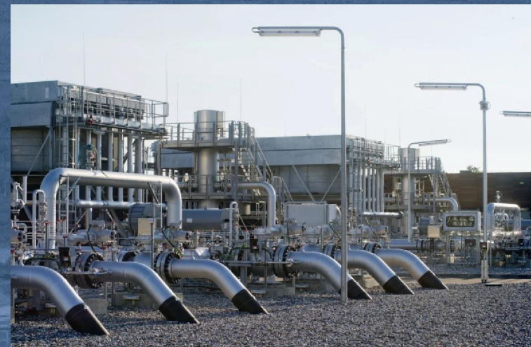
НАСОСНАЯ СТАНЦИЯ ПОДДЕРЖАНИЯ ПЛАСТОВОГО ДАВЛЕНИЯ (НСПД)
