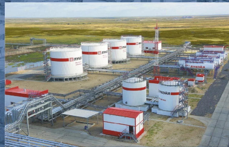
ДОЖИМНАЯ НАСОСНАЯ СТАНЦИЯ УСТАНОВКИ ПРЕДВАРИТЕЛЬНОГО СБРОСА ВОДЫ (ДН)
